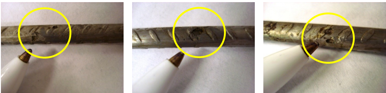
Fig. 5 – Pites de corrosão das armaduras (amostras C50)
